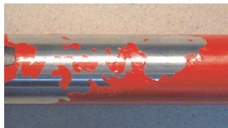
② 塗装の剥がれ
