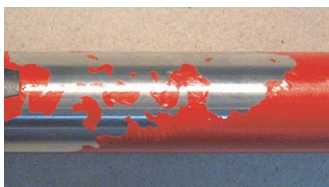
② 塗装の剥がれ
